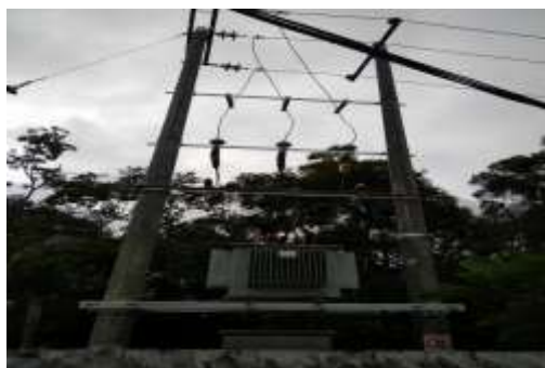
新安装的变压器
