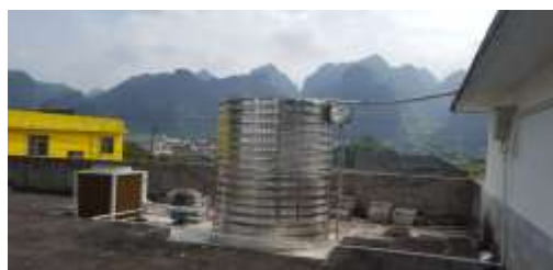
男生宿舍楼供热水设备
